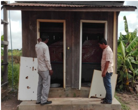
Die beschädigte Toilette
